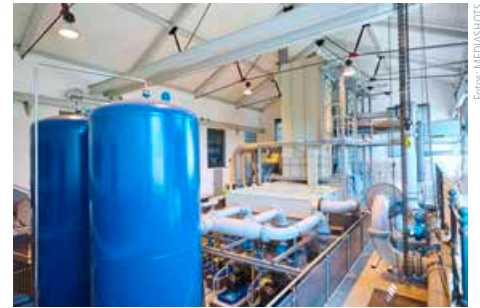
Modernste Technik: Im Hintergrund ist die Entsäuerungsanlage zu sehen. Sie arbeitet mit Luft.
